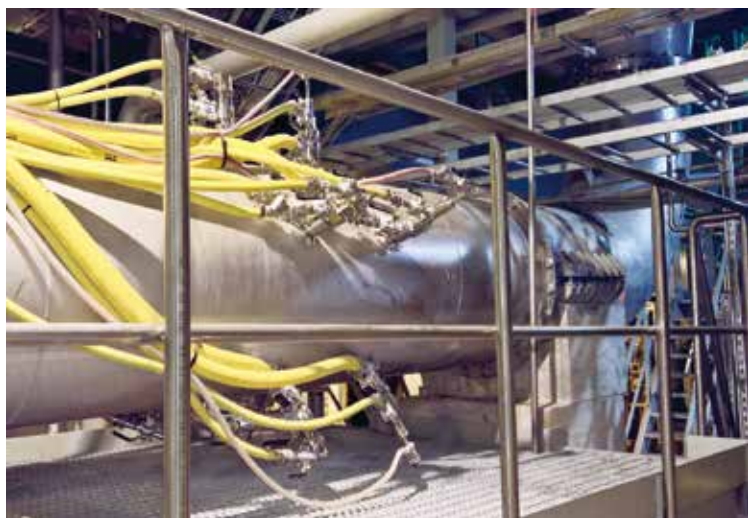
某大型纸板机在最接近流浆箱的位置， 安装了创捷®闪急混合反应阳离子混合站和阴离子混合站
